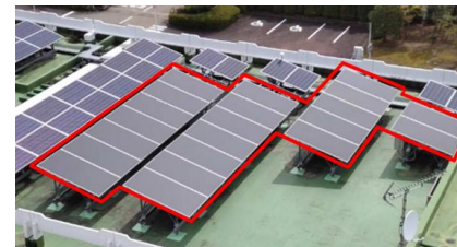
当社研究開発センター屋上に設置したガラス型ペロブスカイト太陽電池（写真赤枠内）
